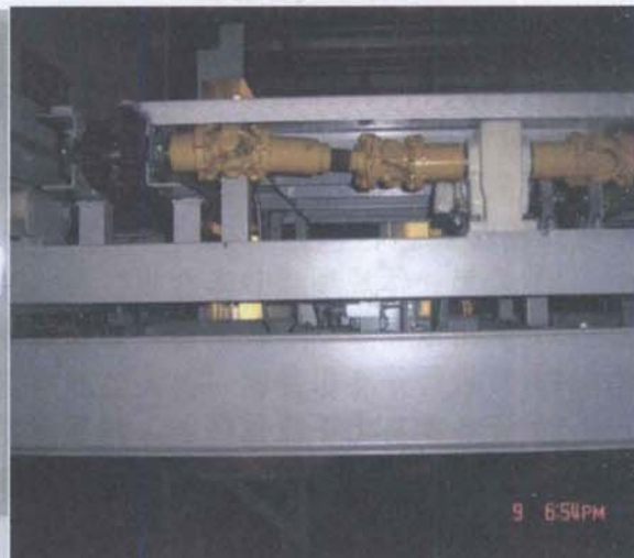
图C7-6 设备搬运系统
