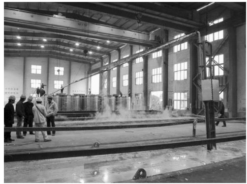
图 6-14 用抽锌泵将锌液从锌锅抽到锌液储存罐
